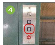
コンベヤが停止したら1を押す
