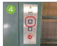
コンベヤが停止したら2を押す
